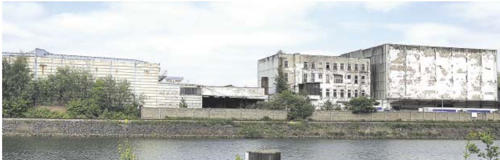
Kräftig bröckelt der Putz an den ehemaligen Frigoscandia-Gebäuden im Stadthafen. Ein Käufer ist nicht in Sicht.
