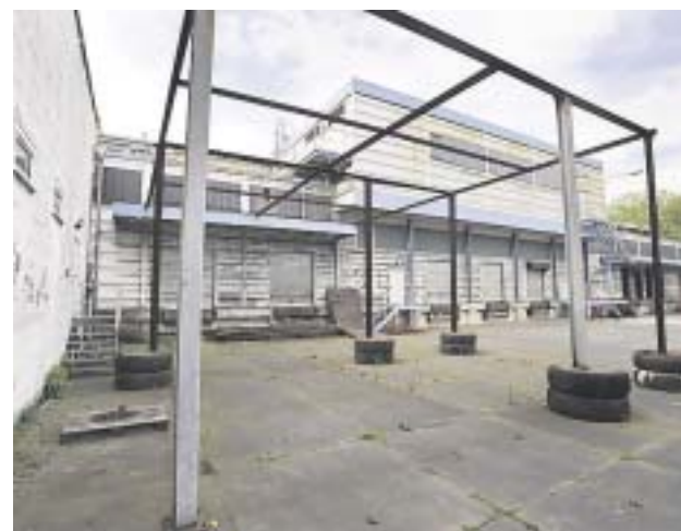
Verwaist sind die Laderampen an den Kühlhäusern. Sie sind voller Altlasten und haben Mängel im Brandschutz.
