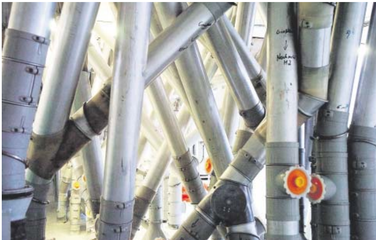
Wie Mikado-Stäbchen stehen die Verbindungsrohre in allen Etagen der Getreidemühle.
